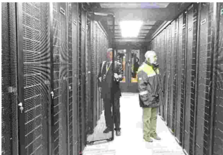
TECNOLOGIE L'interno avveniristico del Green Data Center Eni nel sito di Ferrera Erbognone, teatro del vertice tra azienda e Cnr
