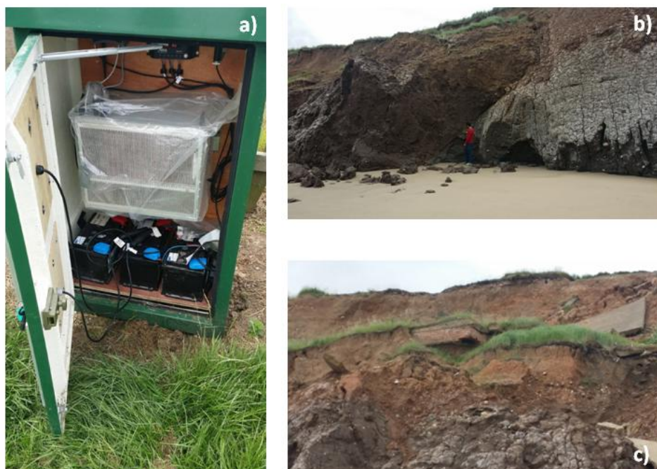
Figura 4 - Sistema Prime installato sulla costa orientale della Gran Bretagna nei pressi di Aldbrough nel East Riding of Yorkshire (UK): a) sistema Prime; b) e c) esempi di collasso.
