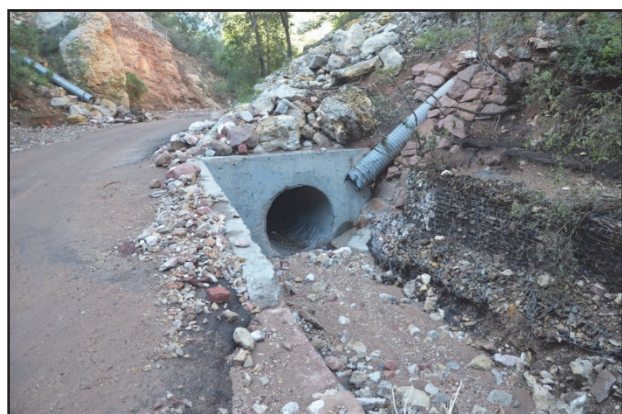
Figura 5 – Tombatura di un canale di drenaggio nell'area di Manitou Springs, CO, interessata da 3 alluvioni nel 2013. (Foto: USGS)
